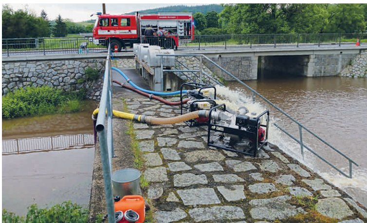
Švihov – čerpání vody
