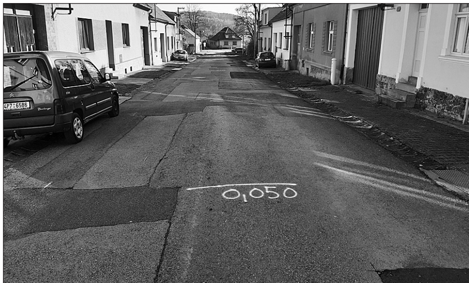
Rozbitý a nerovný povrch Tyršovy ulice
