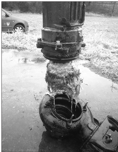
Čerpadlo poškozené vlhčenými kapesníčky (březen 2021)
